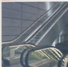
D escalera mecánica
